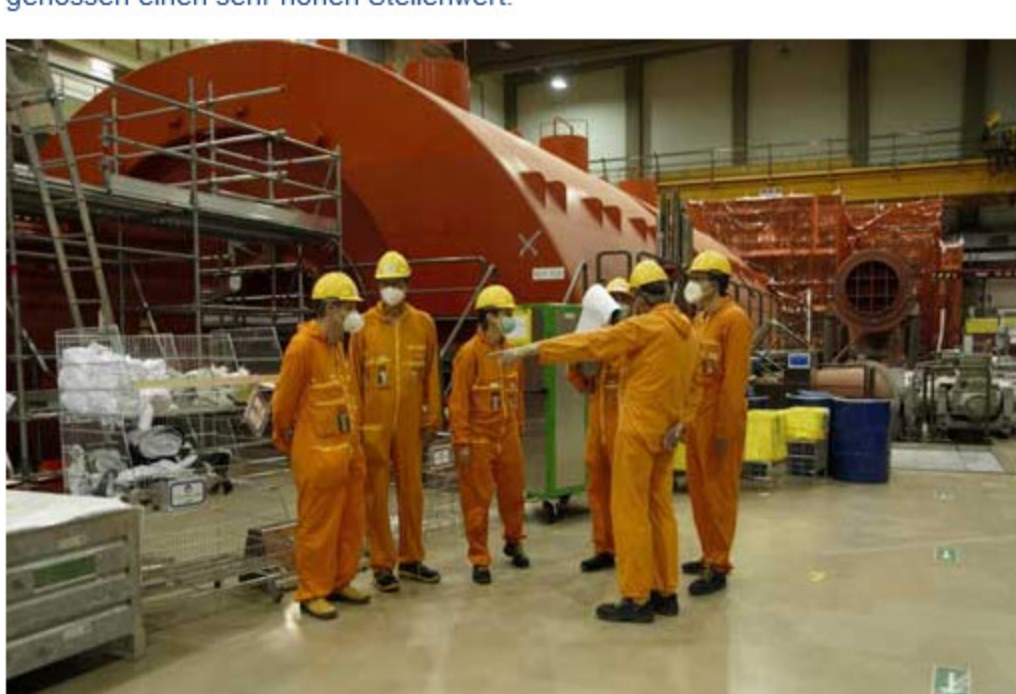
Im Maschinenhaus von Block B wurde im aktuellen Abbau-Cluster Herr Dr. Krebber (rechts) angesichts der beeindruckenden Turbinen (im Hintergrund) gezeigt, wo und wie der Generator als nächster großer Schritt ausgebaut wird.
