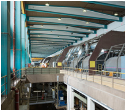
Blick in die Maschinenhalle mit 600-Megawatt-Turbosätzen
