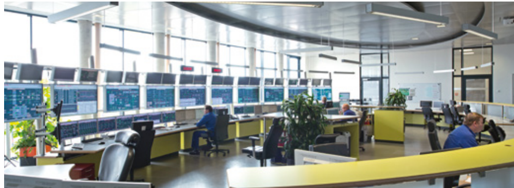
In der Leitstelle werden die Kraftwerksabläufe gesteuert.
